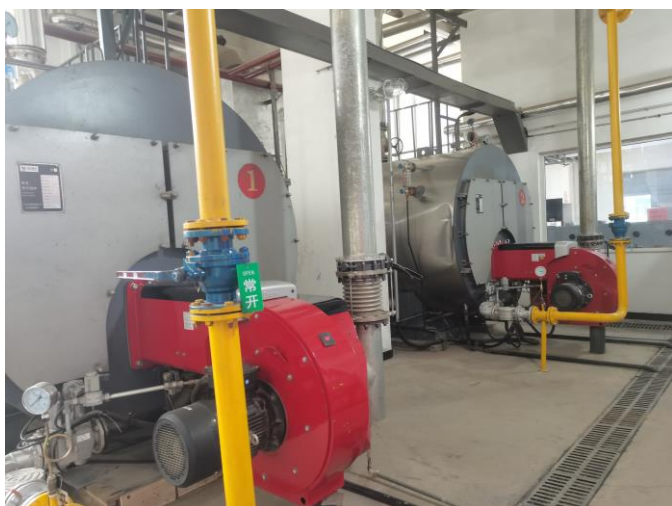
两台燃气锅炉
