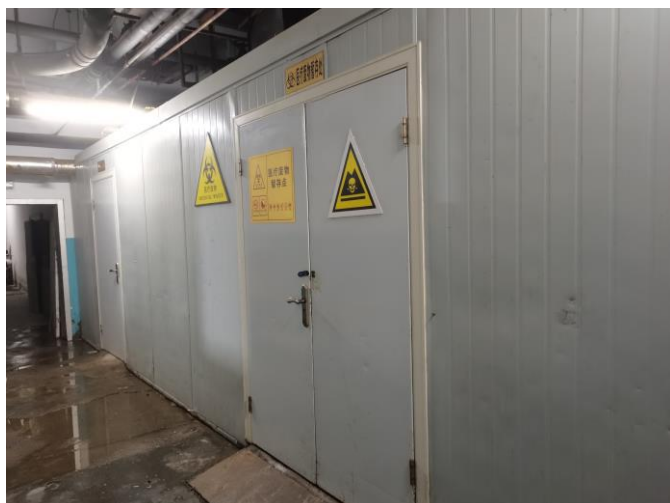
医疗废物暂存间
